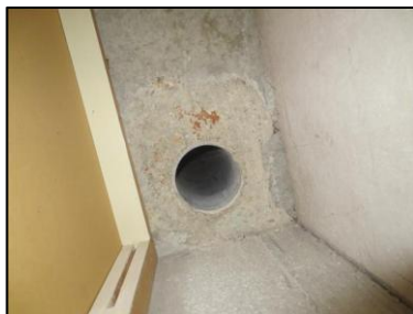
Photo N° 6 AMIANTE CIMENT Placard technique Gáz +2 Conduit de ventilation Ventilation haute (Fibres-ciment)
